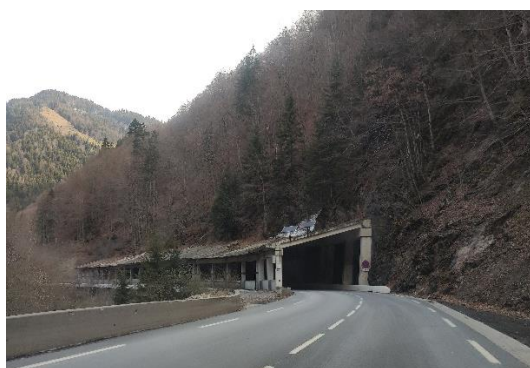
Photo 2 Ouvrage pare-bloc sur la RD12 au niveau du défilé des Etroits (source : Agrestis)
